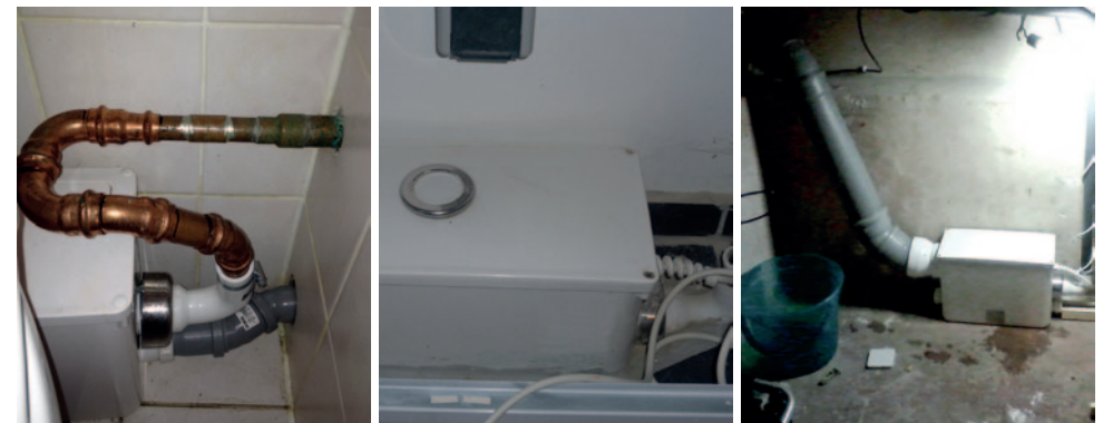
Beispiele für fehlerhaften Einbau >>
