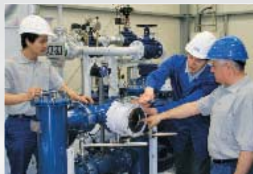
Inbetriebnahme und Schulung durch Lechler Mitarbeiter
