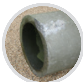
Kad površinsko oštećenje sprječava pouzdano vanjsko brtvljenje
